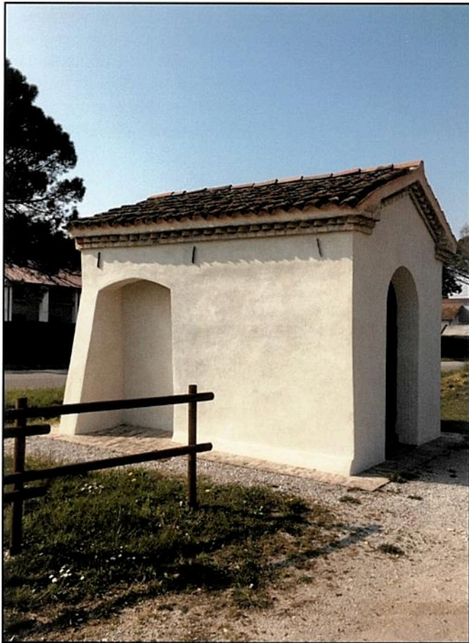
Esterno del Capitello dopo l'attuale intervento di tinteggiatura.
