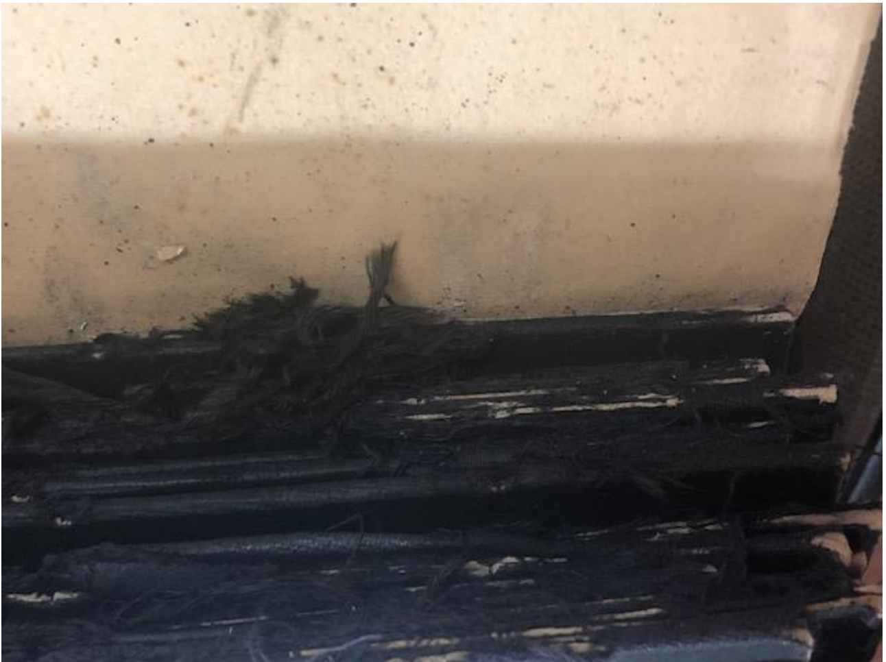
CUCITURA DANNEGGIATA, DECADIMENTO FASCICOLI
