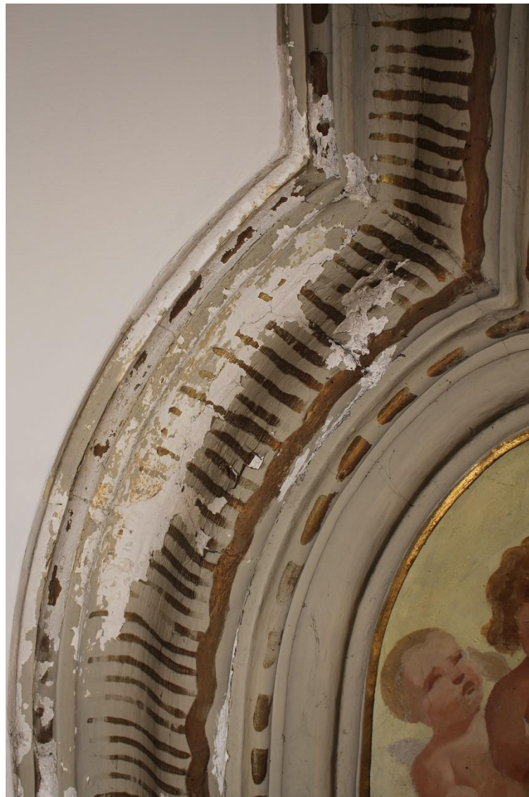
Una zona di degrado delle cornice perimetrale.
