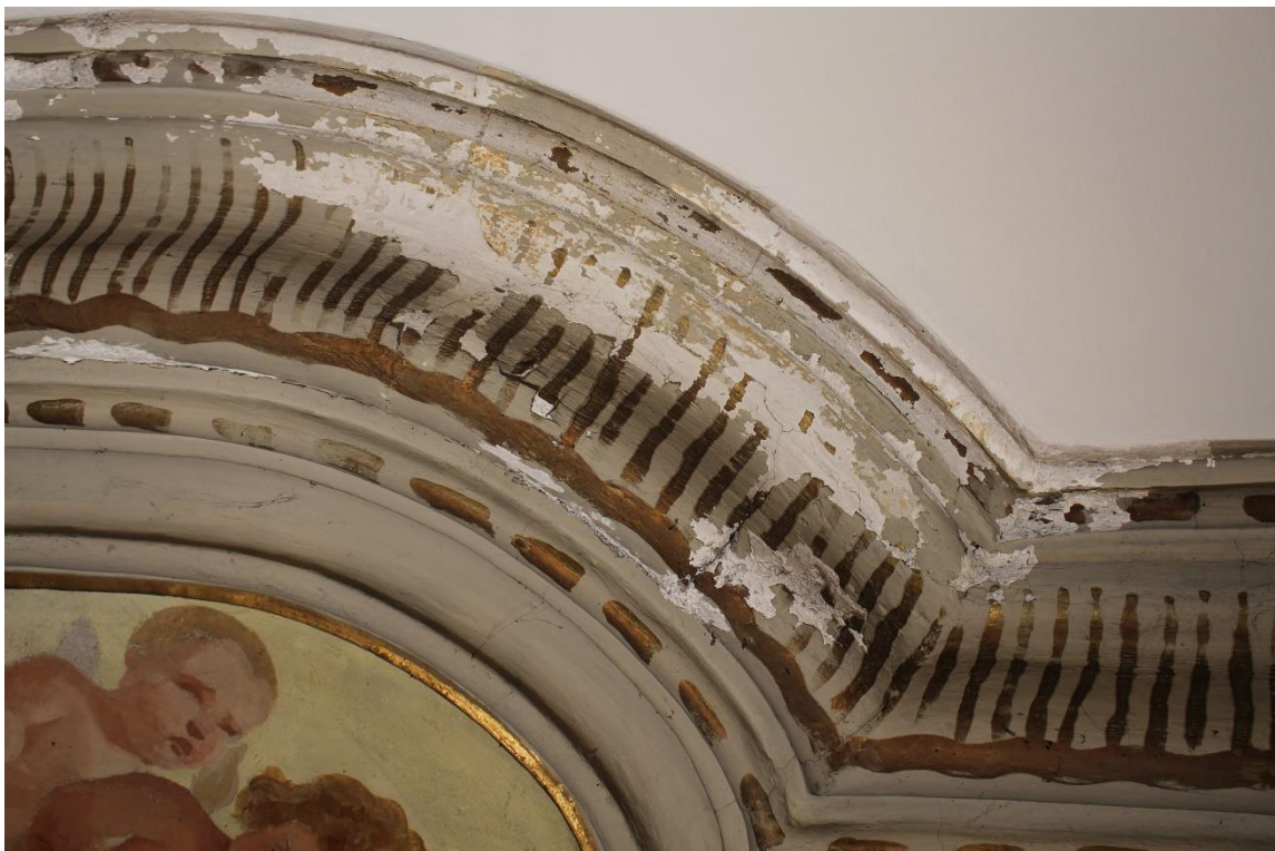
Il degrado della cornice perimetrale
